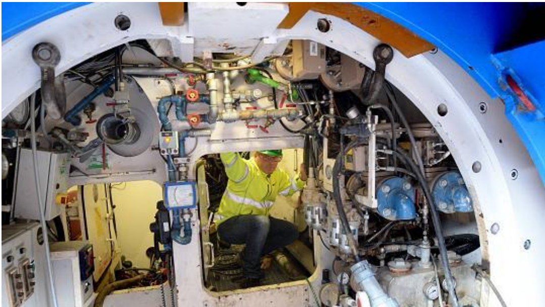
Werksleiter Iwan Peters hockt hier im Arbeitsrohr der riesigen Tunnelbohrmaschine. FOTO: Evers
